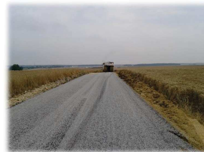
Illustration 430 : Chemin d'accès en grave compactée
